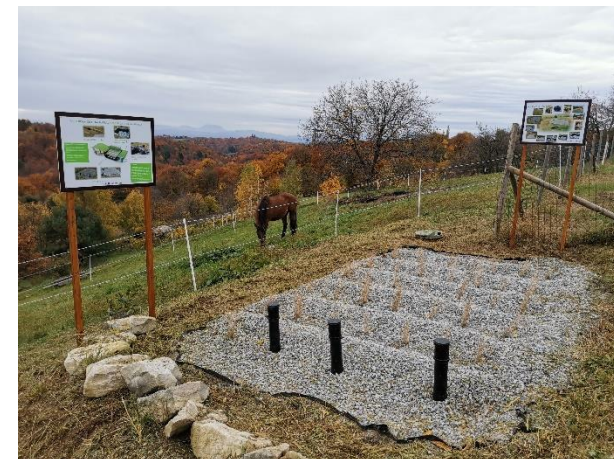
Fotografija zgrajene RČN v okviru projekta Čisto v naravo. Lokacija: Grajenščak.
